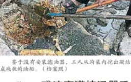
雪州沒有安裝濾油器，工人從溝渠內挖出凝結成塊的油泥。（特寫照）
